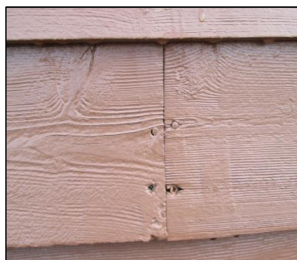
Te strak geplaatst en bevestigingsmateriaal te dicht op einde van de plank
