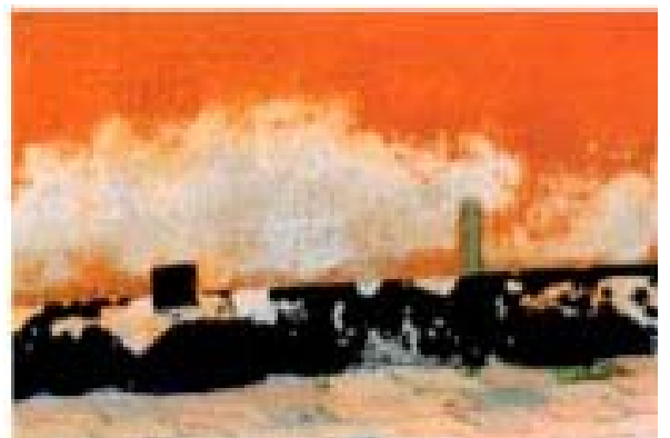
Problemer som følge af opstigende fugt?
