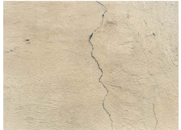
Forekommer der revner i konstruktionen?
